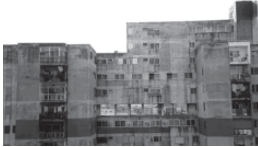
FIGURA 5: Deterioro generalizado de la envolvente vertical. Conjunto Urbano Soldati. 2002. Fuente: PMH, FADU, UBA.
