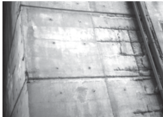
FIGURA 4: Deterioro del hormigón visto del tabique portante, a nivel del 3° piso del nudo circulatorio de 15 pisos. Conjunto Urbano Soldati. 2002. Fuente: PMH, FADU, UBA.
